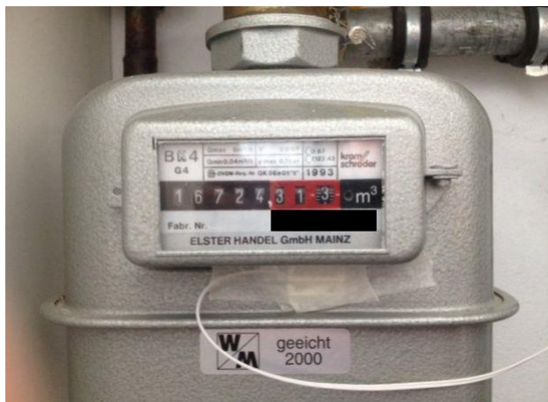
Abbildung 4: Gaszähler mit Reed-Kontakt
