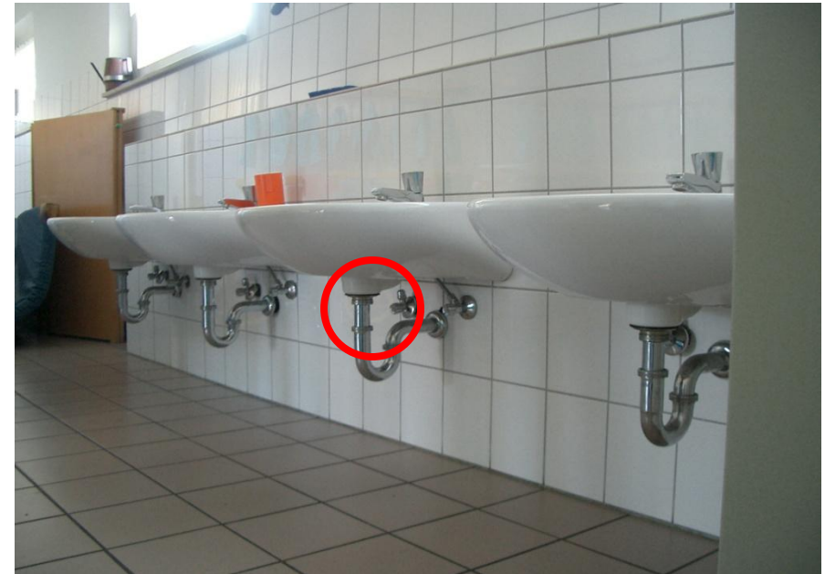
Waschbecken mit abgeklemmtem Warmwasser
